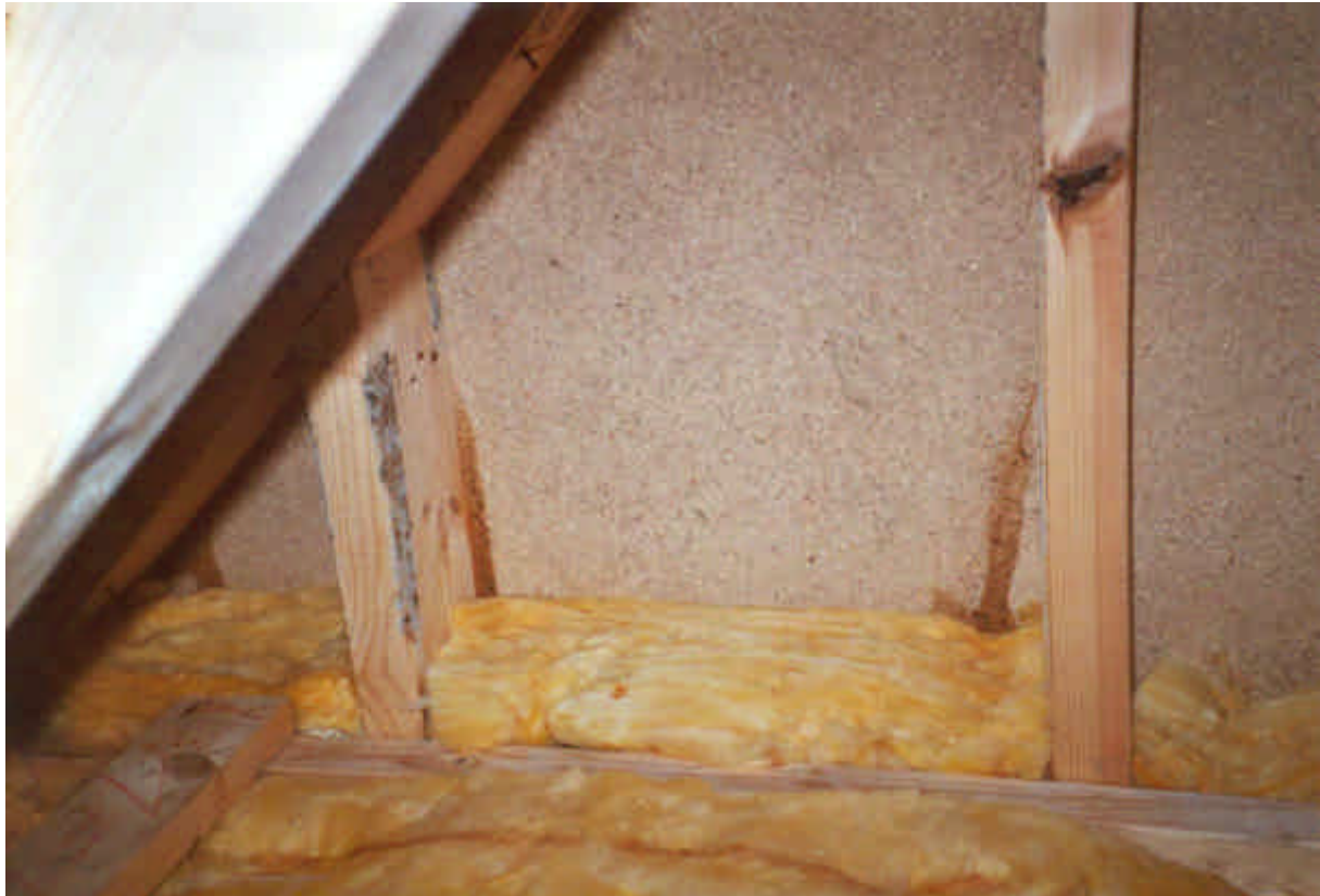
Bei diesem Schaden lag die Folie unter der Kehlbalkenlage nicht an der Dämmung an. Die Folge: Warmluft lag zwischen Folie und Dämmung vor und trat durch die Dämmung an kleinen Fehlstellen. Anschließend kondensierte sie im Spitzboden am ungedämmten Giebel.
