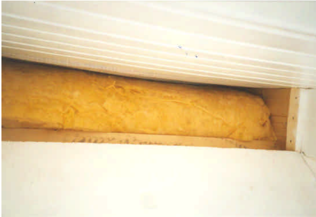
Blick aus der Traufe in die Sparrenvollämmung: Fehlstellen leiten die Außenluft in und auch unter die Dämmung
